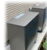
各棟にはそれぞれ12.6kWhの蓄電池を設置(6.3kWh×2台)
