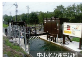
中小水力発電設備
