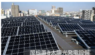
屋根置き太陽光発電設備
