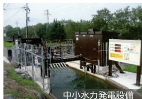
中小水力発電設備
