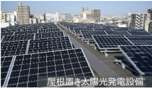
屋根置き太陽光発電設備
