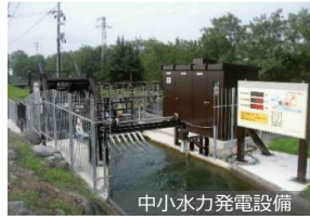
中小水力発電設備
