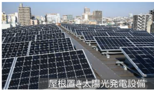
屋根置き太陽光発電設備
