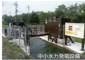
中小水力発電設備
