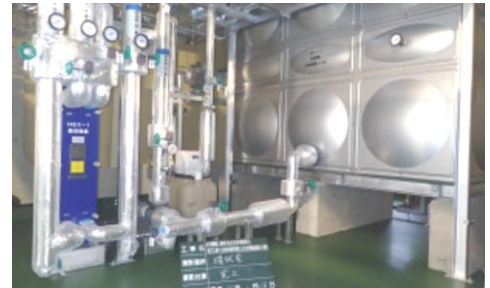
熱源槽と熱交換器
