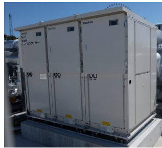
水熱源ヒートポンプチラー
