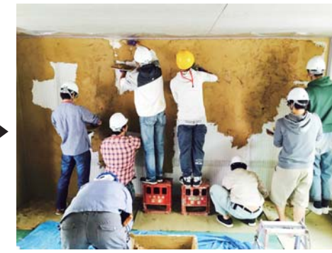
職人に指導を受けながら、学生が施工を実施。手のひらで仕上げることで、表面に風合いをつける。
