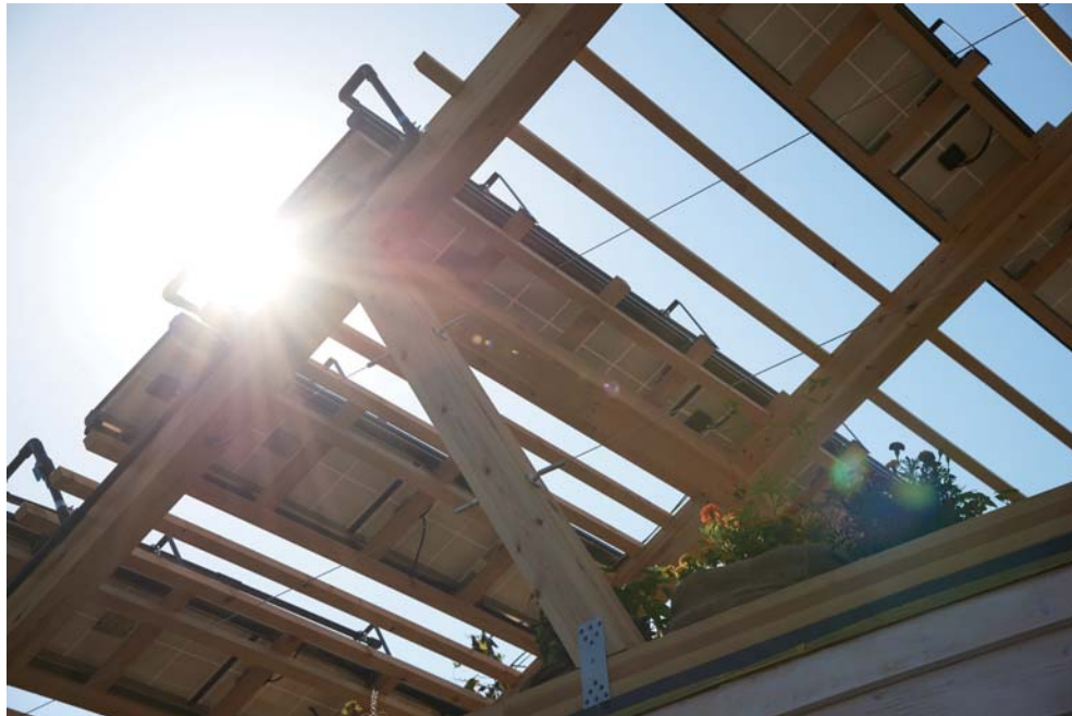
太陽光パネルによる日射遮蔽ルーバー。上部から雨水による灌水を行う。
