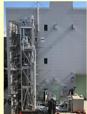
木村化工機尼崎工場内の実証実験装置
