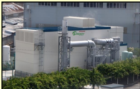
図1 KG-18-V発電所全景
