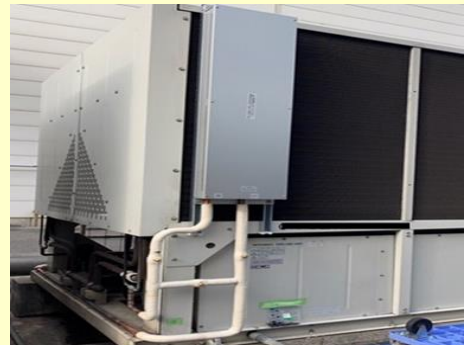
【チラー機器：圧縮機出力37kW 設置画像】
