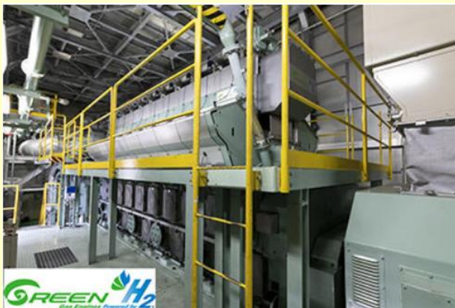
図2 ガスエンジン本体
