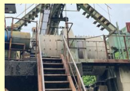
図3 既設ボールミル外観
