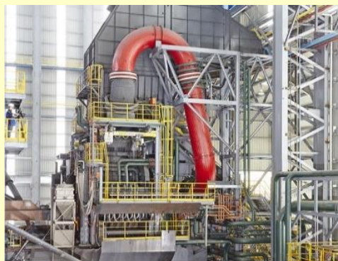
導入設備の外観
