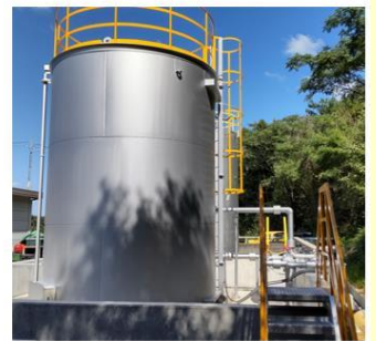
非化石燃料(廃食油)タンク
