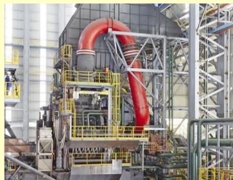
導入設備の外観
