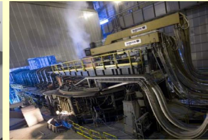
電気炉、電極アーム
