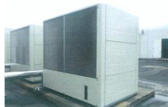
高効率コンデンシングユニット ×4台 冷却能力：226.6kW/h
