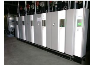
高効率ガス焚きボイラー ×5台 相当蒸発量：3,000kg/h 燃料：都市ガス13A
