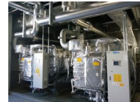
吸収式冷温水機 ×2台 冷房能力：879kW/h 燃料：都市ガス13A
