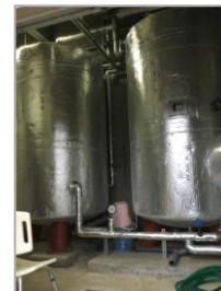
給湯タンク設備
