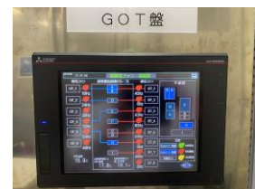
給排気ファン自動制御 システム更新
