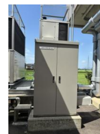
空調熱源機器 電源盤
