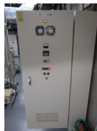
空調 給気インバータ盤
