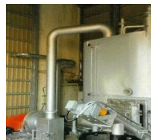
廃タイヤチップボイラ
