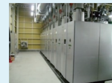
2. 小型貫流ボイラ 3,000kg/h (1台あたり) (※)
