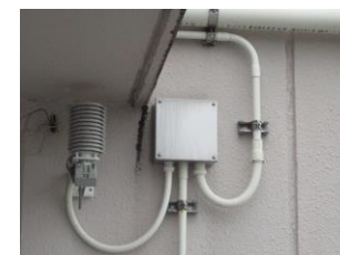
屋上 外気温度センサー
