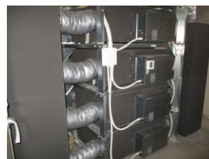
5階西バックヤード 調湿機
