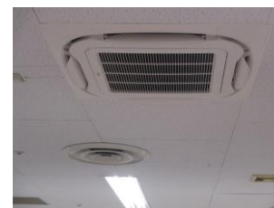
5階売場 空調室内機
