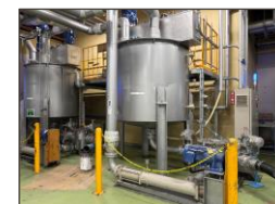
原材料タンク
