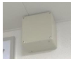
差圧計 調理室内の陽圧保持
