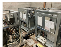
高効率冷凍機 × 5台
