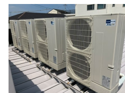
高効率空調機(室外機) × 4台
