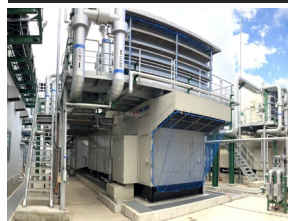
磯部工場 2号ガスタービン
