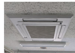
空調（室内機）×22台 消費電力：3.44～3.45kW (※)
