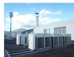
空冷式設備用パッケージエアコン（室外機）
