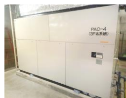
空冷式設備用パッケージエアコン（室内機）
