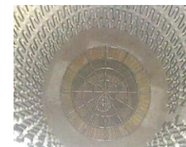
電気式熱処理炉の対流化（炉内対流発生用ファン）
