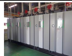
小型貫流蒸気ボイラ
