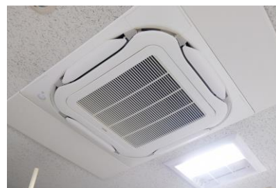
高効率空調設備
