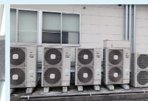
空調機 (室外機)
