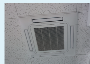
1. 空調機 (室内機) 冷房能力 20.0kW (※) 暖房能力 22.4kW (※)
