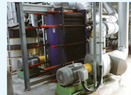
4. 空調系熱交換器 冷却能力 1,350kW (350JRT)
