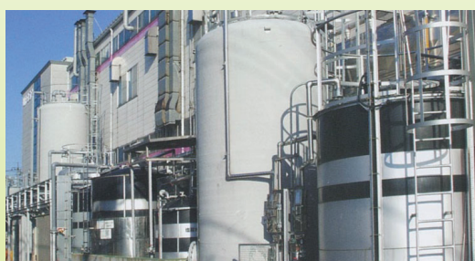
排水リサイクル設備
