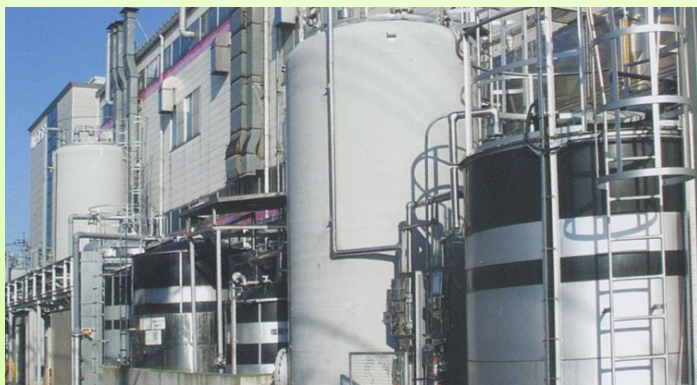
排水リサイクル設備
