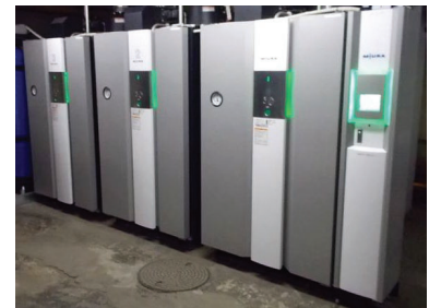
②高性能蒸気ボイラ
