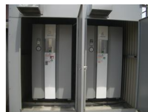
貫流ボイラ：2台 蒸気量：2t/h 都市ガス13A
