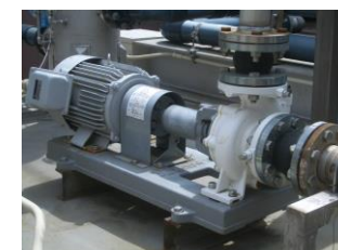
逆洗ポンプ：1台 全揚程：23m
