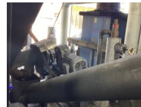
廃タイヤチップ受入供給装置 (搬送パイプコンベアー) 搬送能力：最大85kg/h
