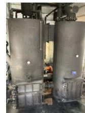
廃タイヤチップボイラー：1台 焼却能力：75～95kg/h
