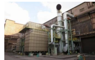
屋外設備（完成後）
