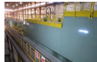
屋内設備（完成後）
