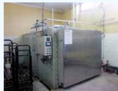
1. 高圧殺菌釜 (外観) 制限圧力 0.13MPa 自動運転装置組込
