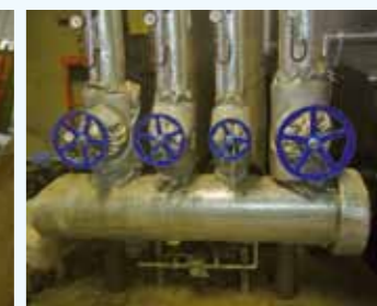
2. 蒸気ヘッダー 設置場所：ボイラ室
