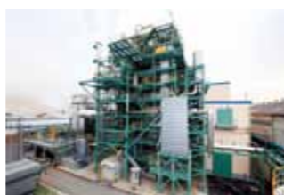
バイオマスボイラー発電設備
