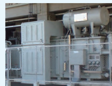
2. 整流器 整流効率の良い低電流高電圧タイプ
