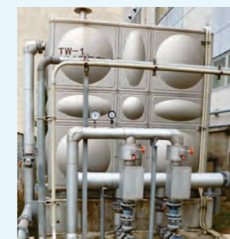
3. 温排水熱回収設備 (温排水タンク)
