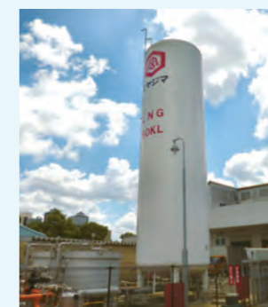
5. LNGサテライト設備 (貯槽60kL)
