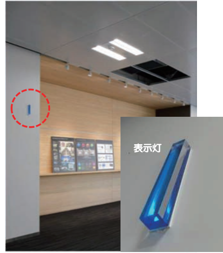
自然換気有効表示灯 (見える化)
