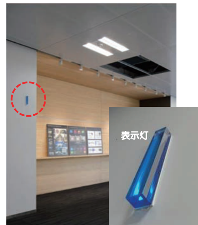
自然換気有効表示灯
