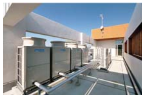
高効率空調機
