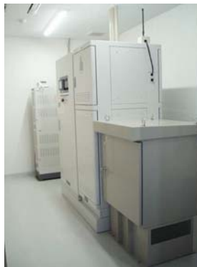
Liイオン蓄電池
