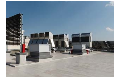
設置されたEHPとGHP(室外機)
