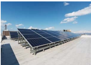
屋上設置太陽光パネル
