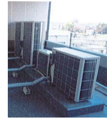
高効率空調機 (空冷式高効率EHP)
