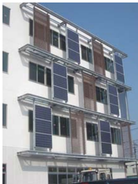
壁面設置太陽光パネル
