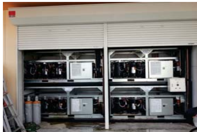
インバータ式高効率冷凍冷蔵機器及び冷凍機による水蓄熱冷蔵システム
