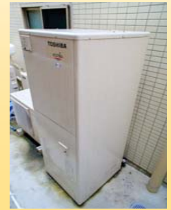
(貯湯ユニット)
