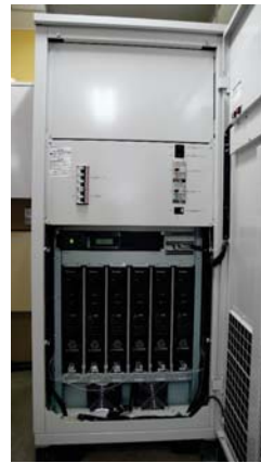
定置式リチウム イオン蓄電池
