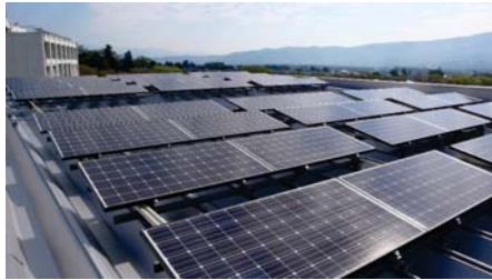
太陽光発電 モジュール
